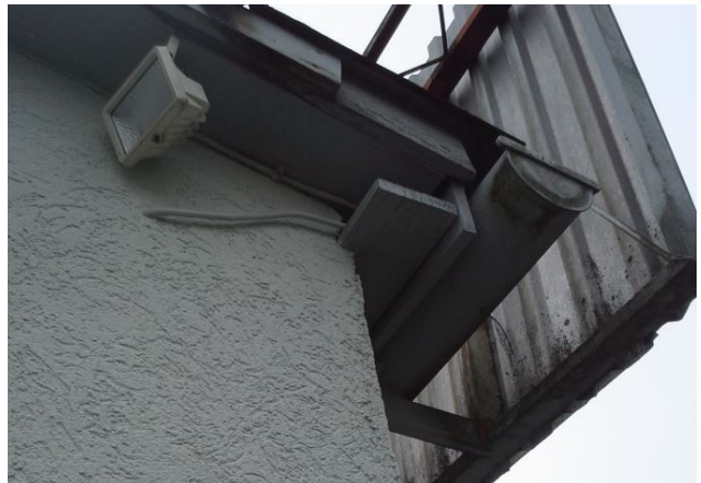
Abb. 20: Holzabsatz hinter der Dachrinne an der Ostseite von Gebäude Nr. 3 mit Nistplatzpotenzial für Nischenbrüter
